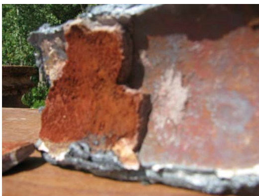
Рис.5. До восстановления котла. Карбонатные отложения 5,0-7,0 мм вырезка трубы газового котла ЗИО-60.
