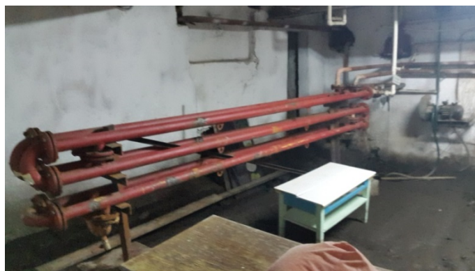
Рис. 2. Фото Бойлера – накопителя горячей воды
